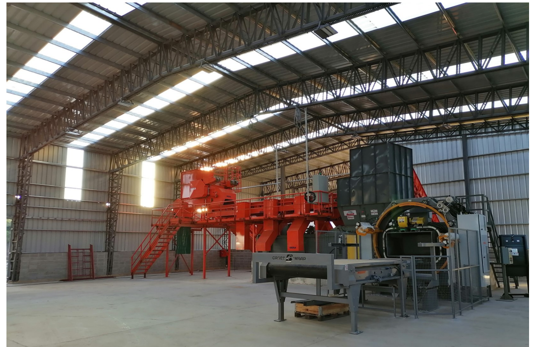
MAQUINARIA PARA LA CLASIFICACIÓN Y PROCESAMIENTO DE RESIDUOS
